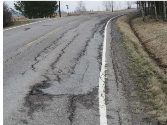
Figur 10 viser konsekvensene av manglende dreneringsvedlikehold og dårlig bæreevne i massene under asfaltdekket.
