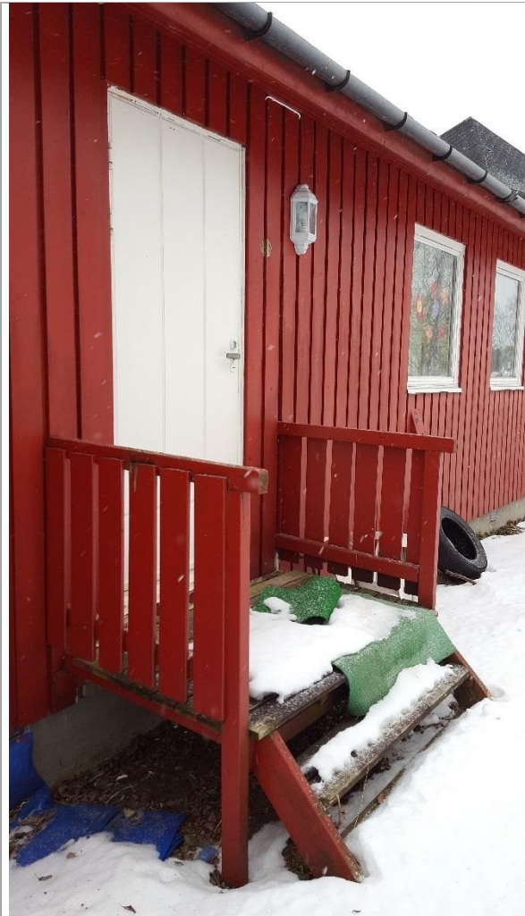
Bilde 6: Trykkimpregnert trevirke på trappene
