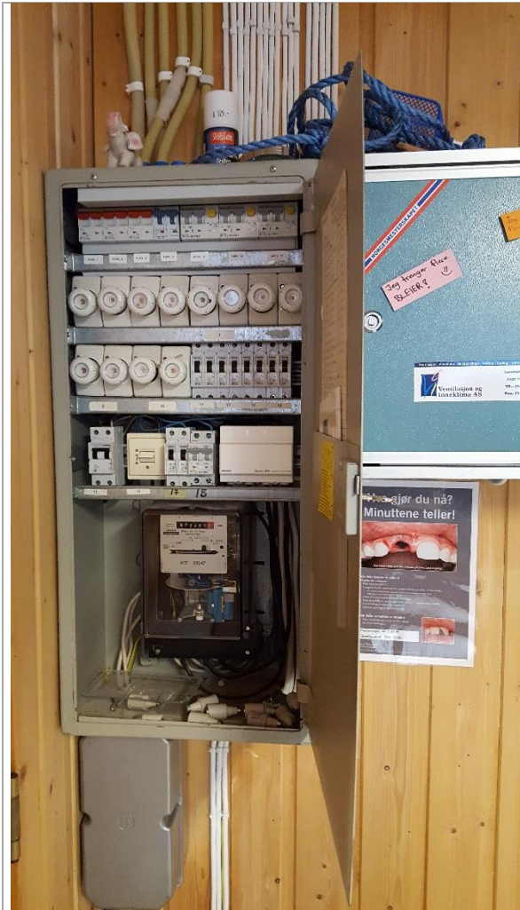
Bilde 10: Hodevtavle skal bytes ut med en ny.
