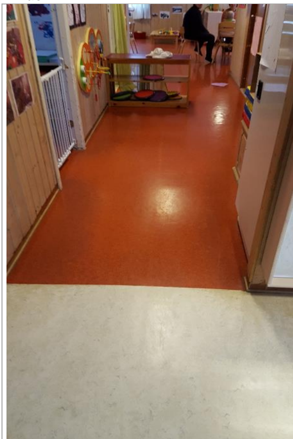
Bilde 3: Gulvbelegg i storbarnsavdeling, ikke prøvetatt. Antas å inneholde ftalater over grensen for farlig avfall pga. alder.
